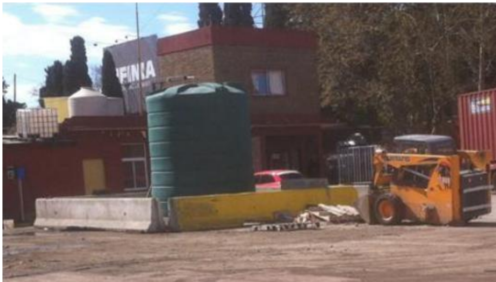
Ilustración 33: Tanque aéreo de gasoil actualmente en uso
