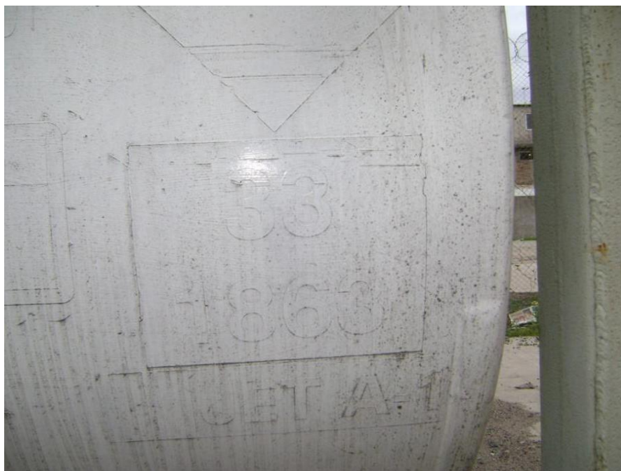
Ilustración 36: Detalle tanque Jet A1
