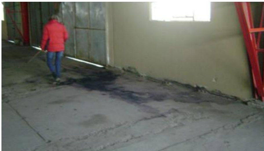
Ilustración 25: Mancha en depósito de surtidores
