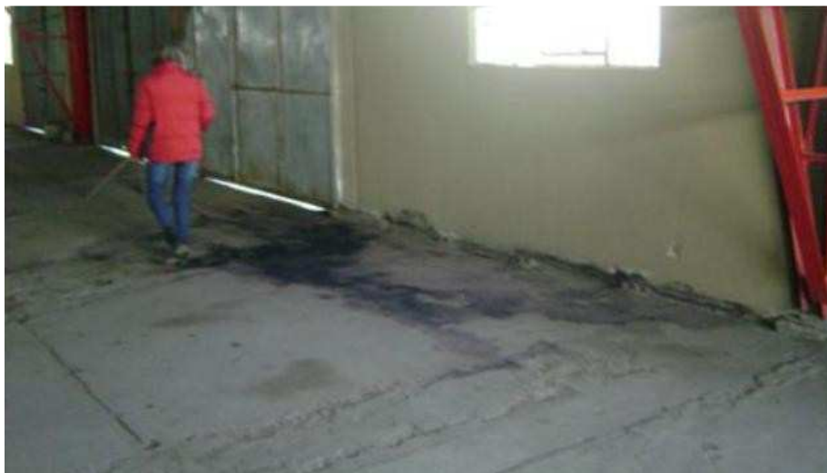
Ilustración 25: Mancha en depósito de surtidores
