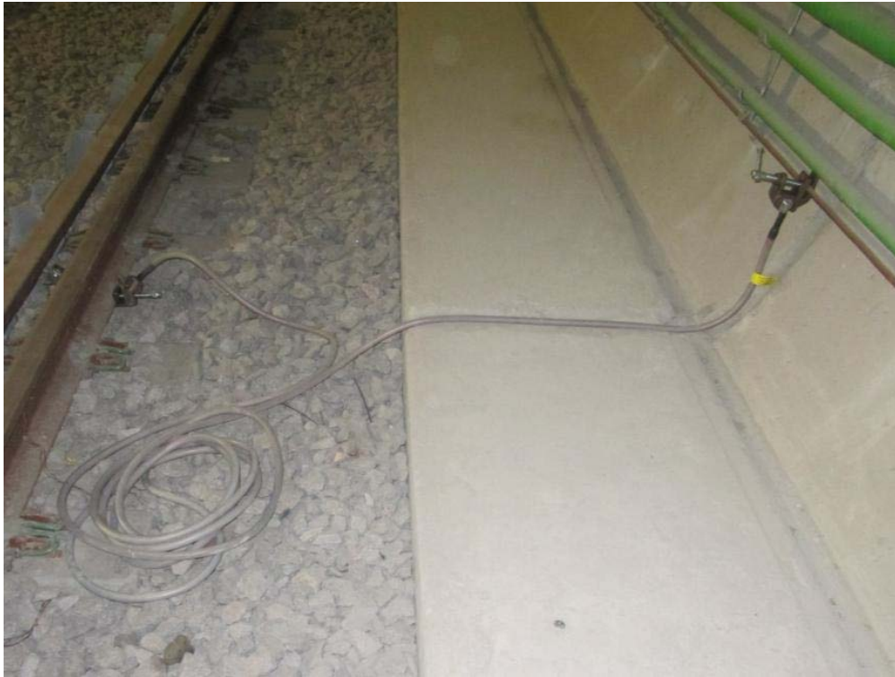
Fig. 4: conexión de riel a puesta a tierra
